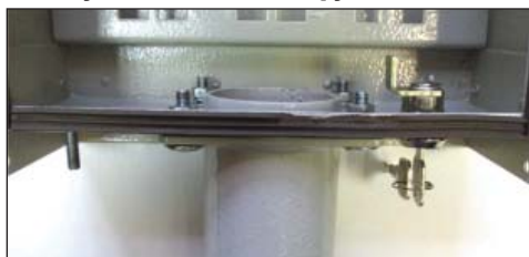
Рисунок 3 – Корпус ящика установленный на трубостойке
