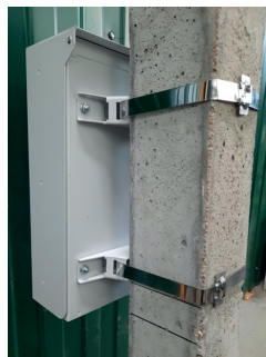
Рисунок 2.7 – Общий вид УКС, смонтированного на опоре при помощи монтажной ленты
