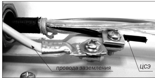
Рисунок 4.11 – Крепление на кронштейне ЦСЭ (металлический трос с полимерным покрытием) кабеля и провода заземления
